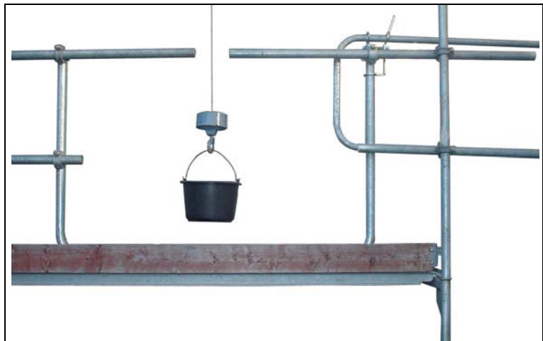
Fig. 14 Sicherung der Be- und Entladestelle
